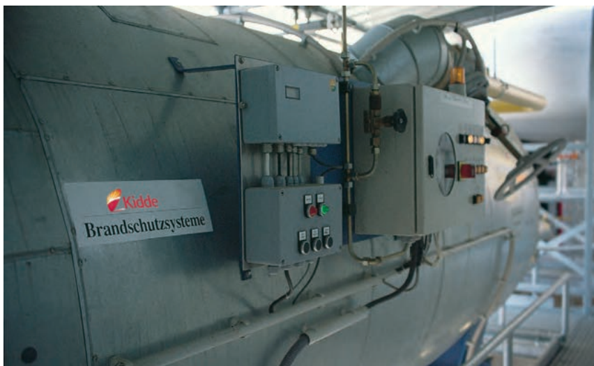
CO 2 -Vorratsbehälter mit Schaltschränken
