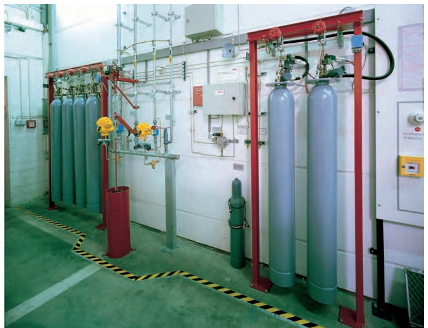
CO 2 -Flaschenbatterie mit Bereichsventilen und pneumatischer Zeitverzögerung
