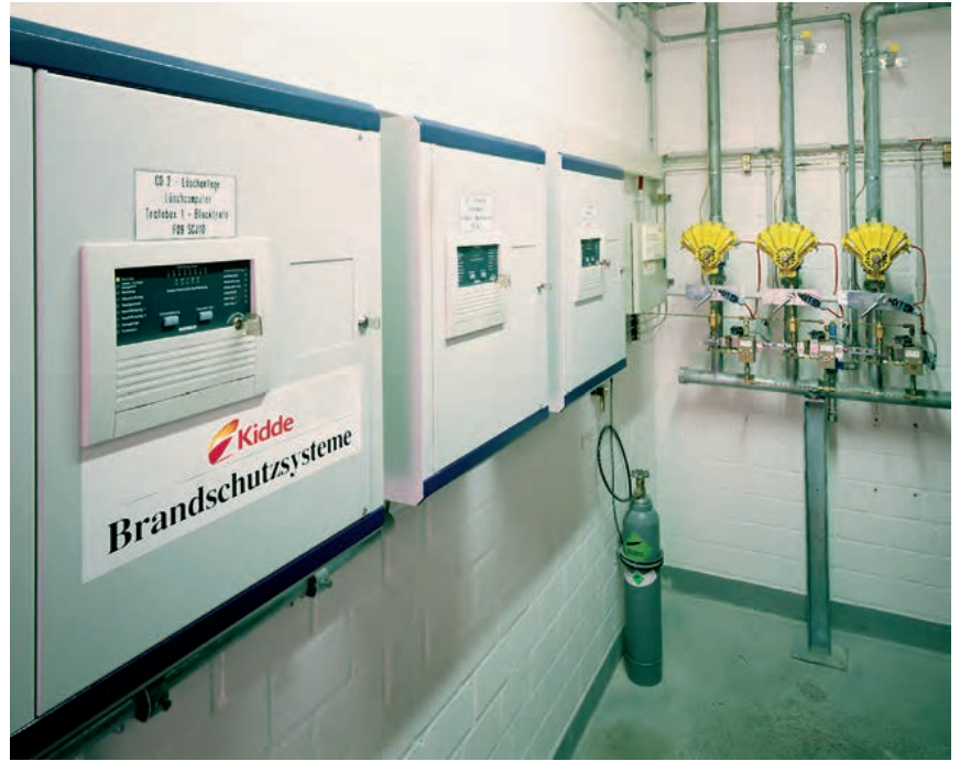
Bereichsventile mit Brandmeldezentralen
