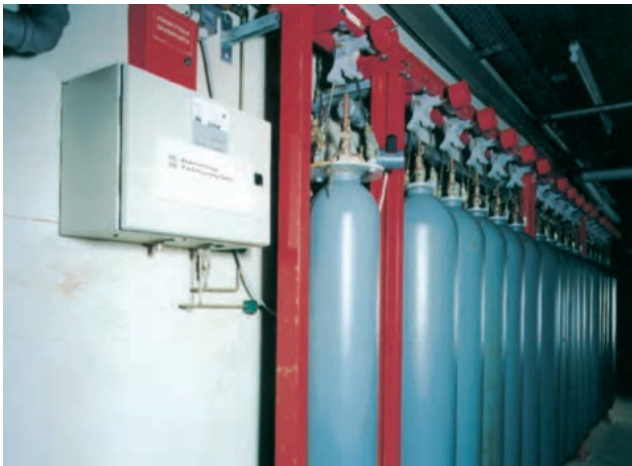
CO 2 -Hochdrucklöschanlage mit pneumatischer Zeitverzögerung
